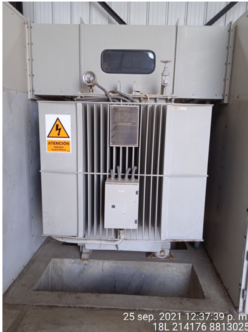
Transformador de Potencia 2800 kVA 2.3/20 kV SE CH Purmacana
