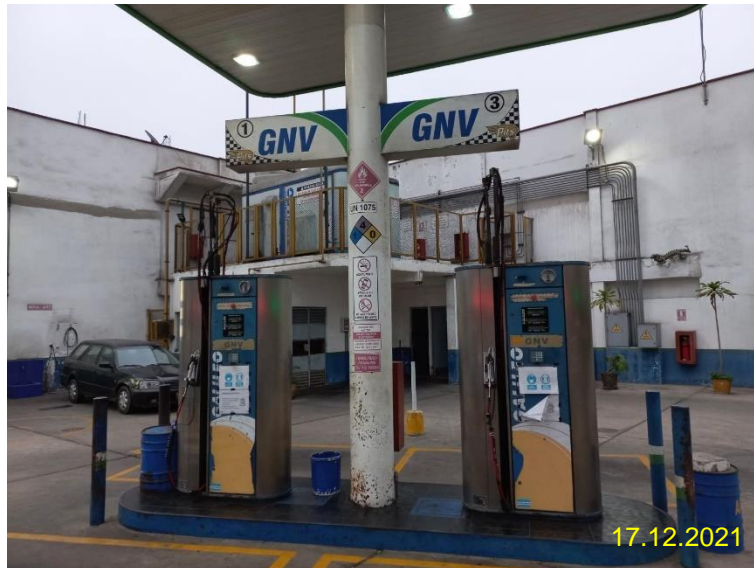
Fotografías N° 1 y 2. Vistas de los dispensadores de la isla N° 1
