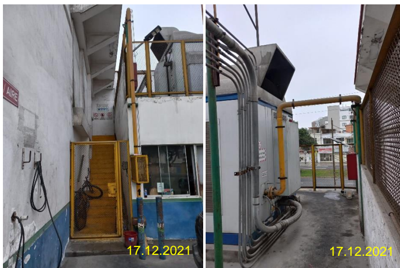
Fotografías N° 3 y 4. Fotografías de tuberías aéreas (Sección 1)
