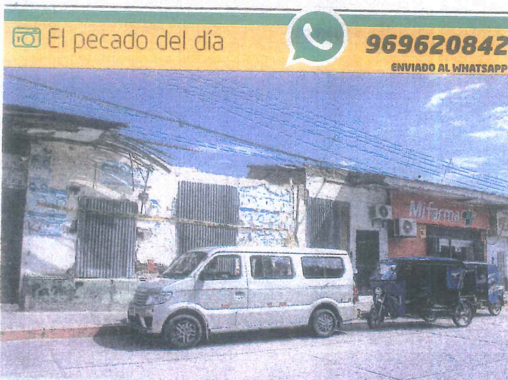
PREOCUPANTE. Frente a la plaza principal de Chulucanas, solo una cinta amarilla advierte del peligro que representa esta pared que podría desplomarse. Asimismo, a los usuarios pareciera no importarles la señalización.
