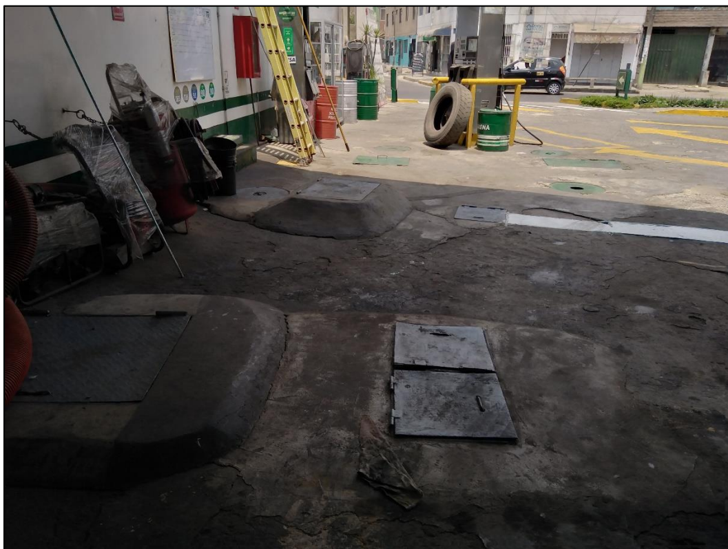
Foto N°6: Vista parcial de la zona de los tanques de combustibles líquidos y la Isla N°2 al fondo.
