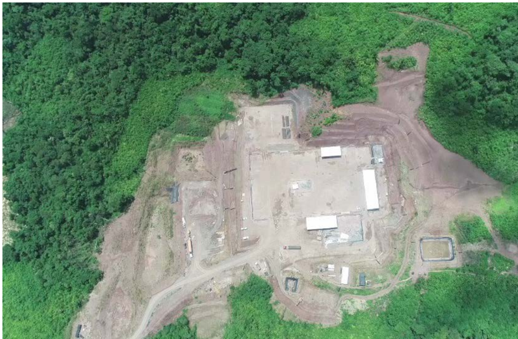
Foto 1. Vista panorámica de la Locación PAD B después de la suspensión temporal (2019).
