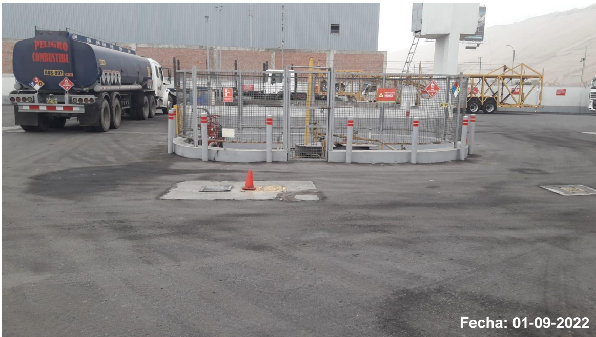
Fotografía N° 3: Vista frontal del área de almacenamiento del tanque de GLP existente
