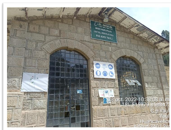
Figura 1. Casa de Máquinas
