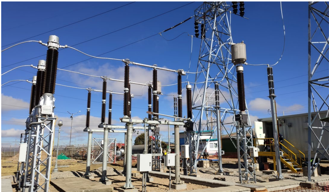
Fotografía N° 03: Vista Panorámica – Bahía 138 kV (CL-1703)
