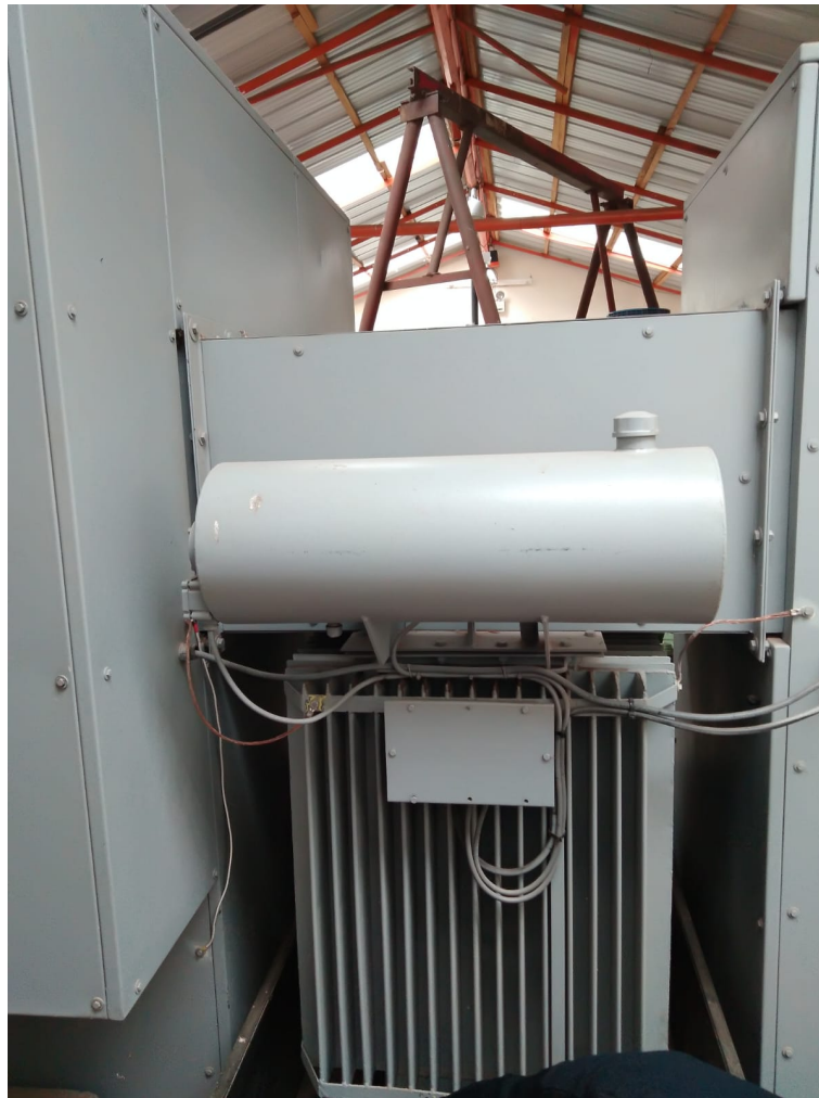
Fotografía N°02: Transformador de Potencia
