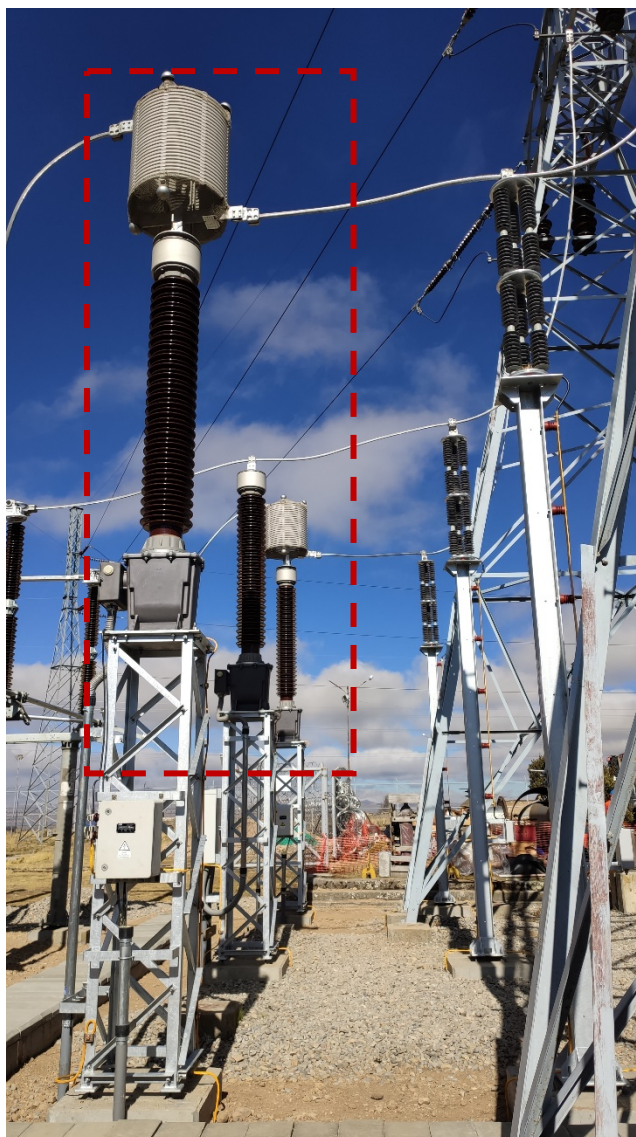
Fotografía N°04: Transformadores de Tensión
