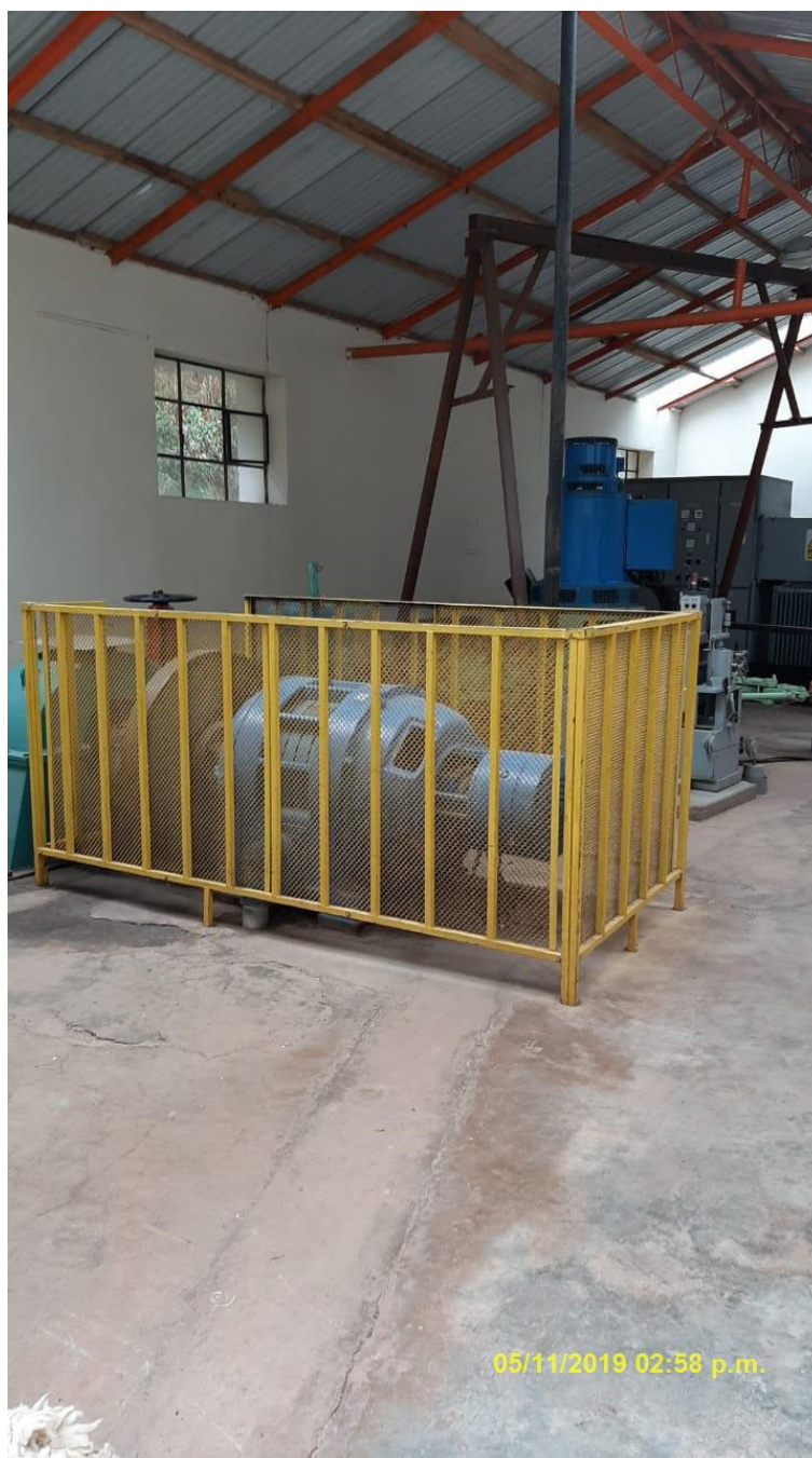
Fotografía N°01: Casa de Máquinas: Grupos de Generación
