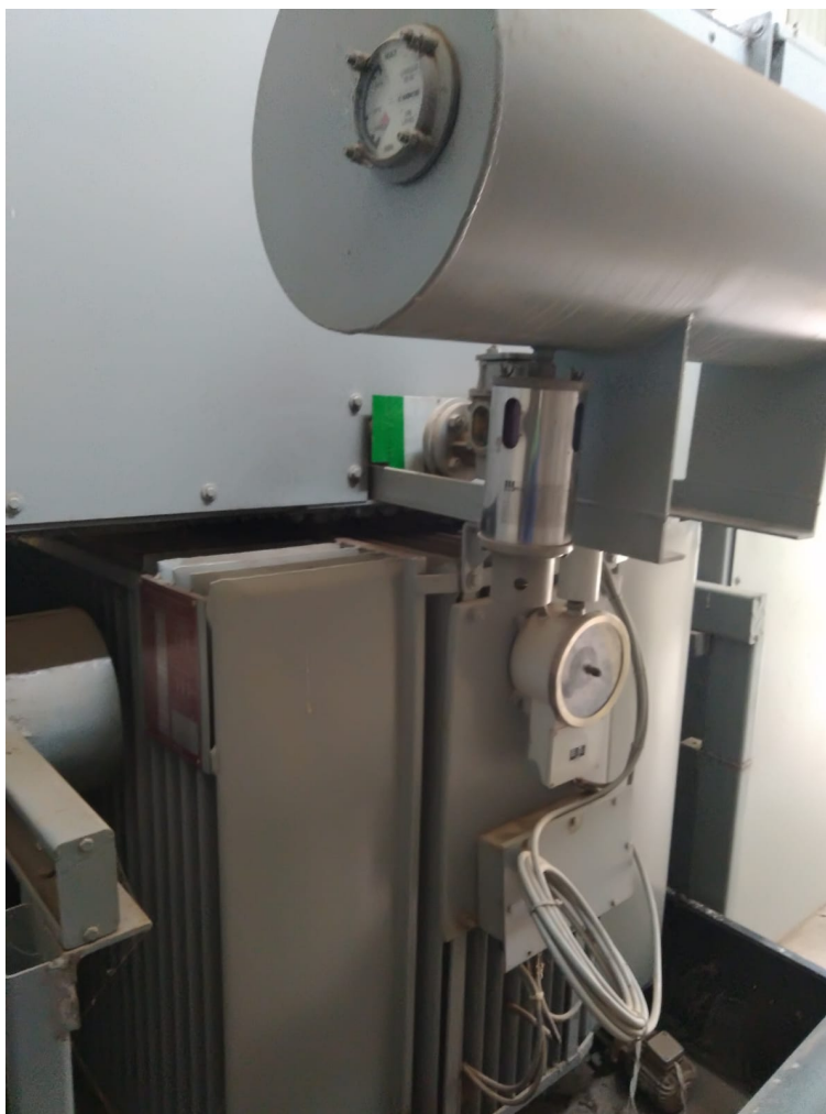
Fotografía N°03: Transformador de Potencia
