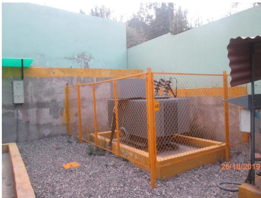
Fotografía N° 3.3 Vista del transformador
