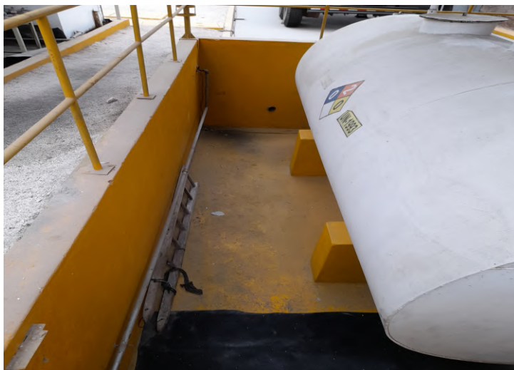
Fotografía N° 2: Tanque de combustible soterrado
