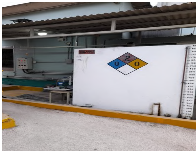
Fotografía N° 3: Vista del Tanque Diario
