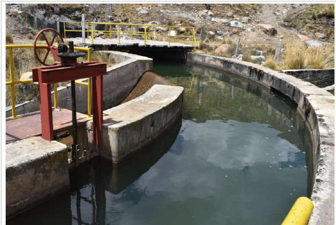
Figura 3.3 – 6 Compuerta de limpieza del Desarenador en la cámara de carga
