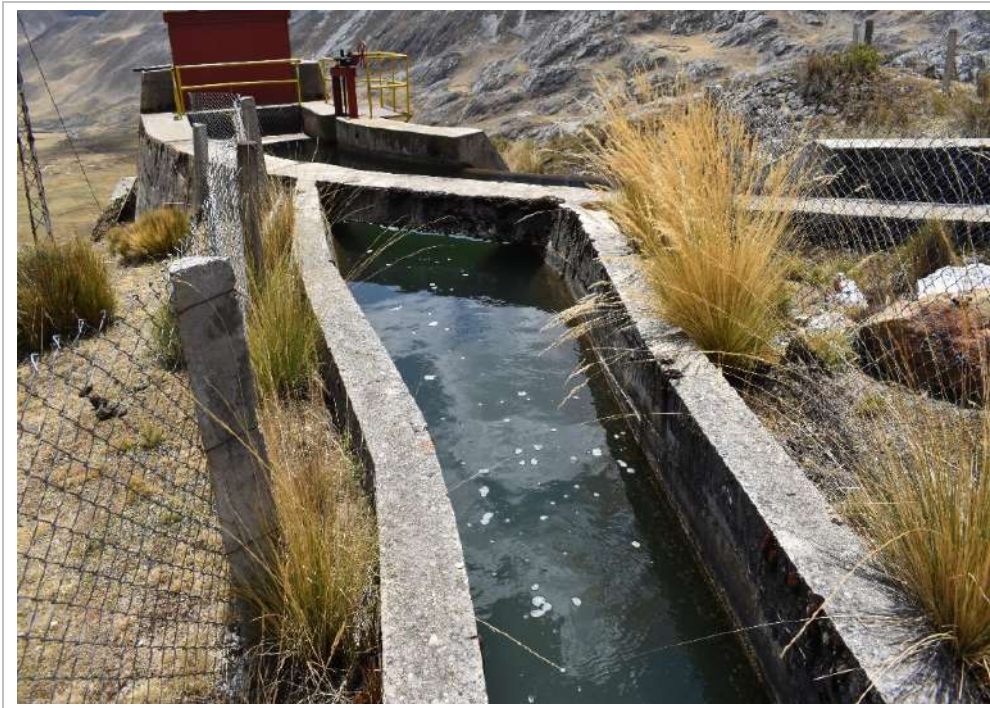
Figura 3.3 – 8 Canal de conducción proveniente de la Bocatoma Cacray
