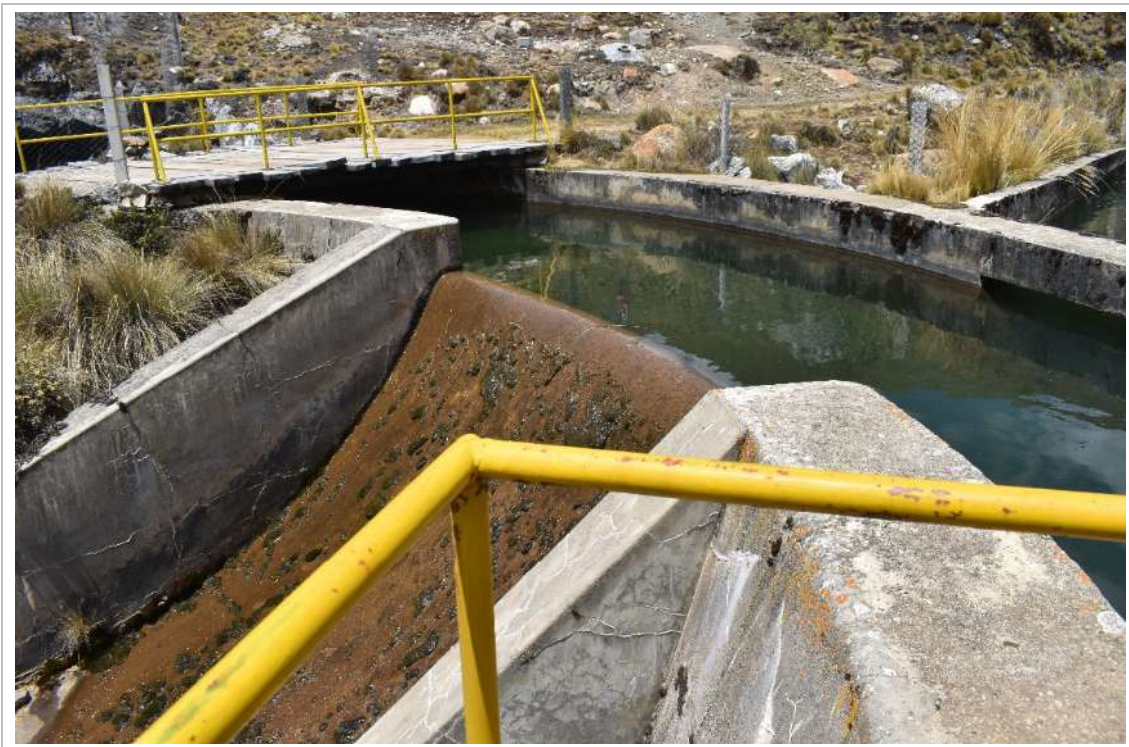
Figura 3.3 – 10 Vertedero lateral de demasía de la cámara de carga
