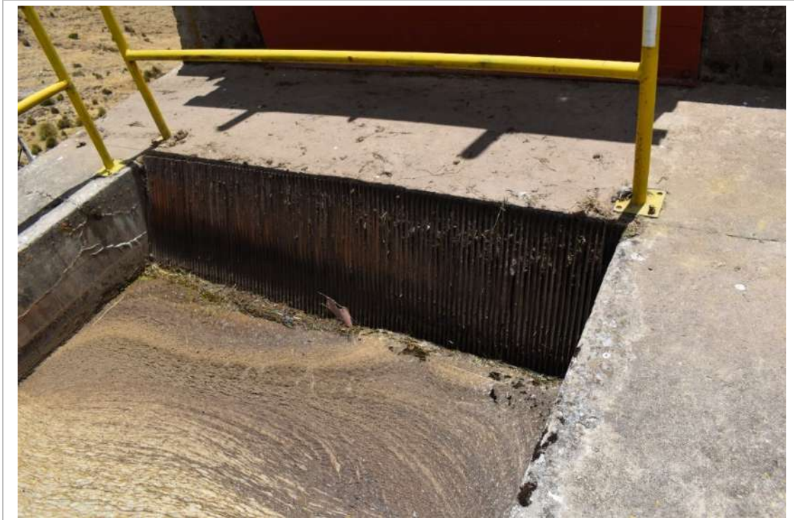
Figura 3.3 – 5 Sedimentos retenidos por la rejilla fina previo ingreso a la cámara de carga
