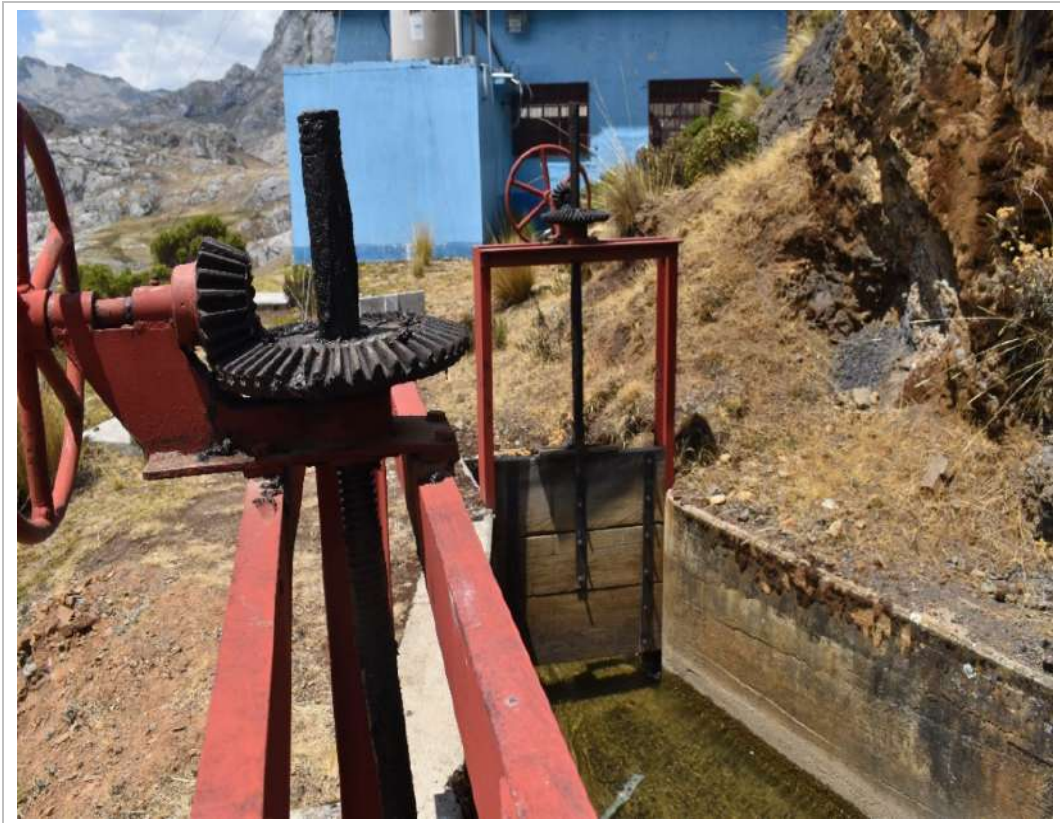
Figura 3.3 - 4 Bocatoma en Río Chicrín – conectado con canal de descarga CH Cacray
