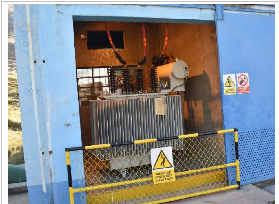
Figura 3.3 - 17 Transformador de potencia (650 kVA)
