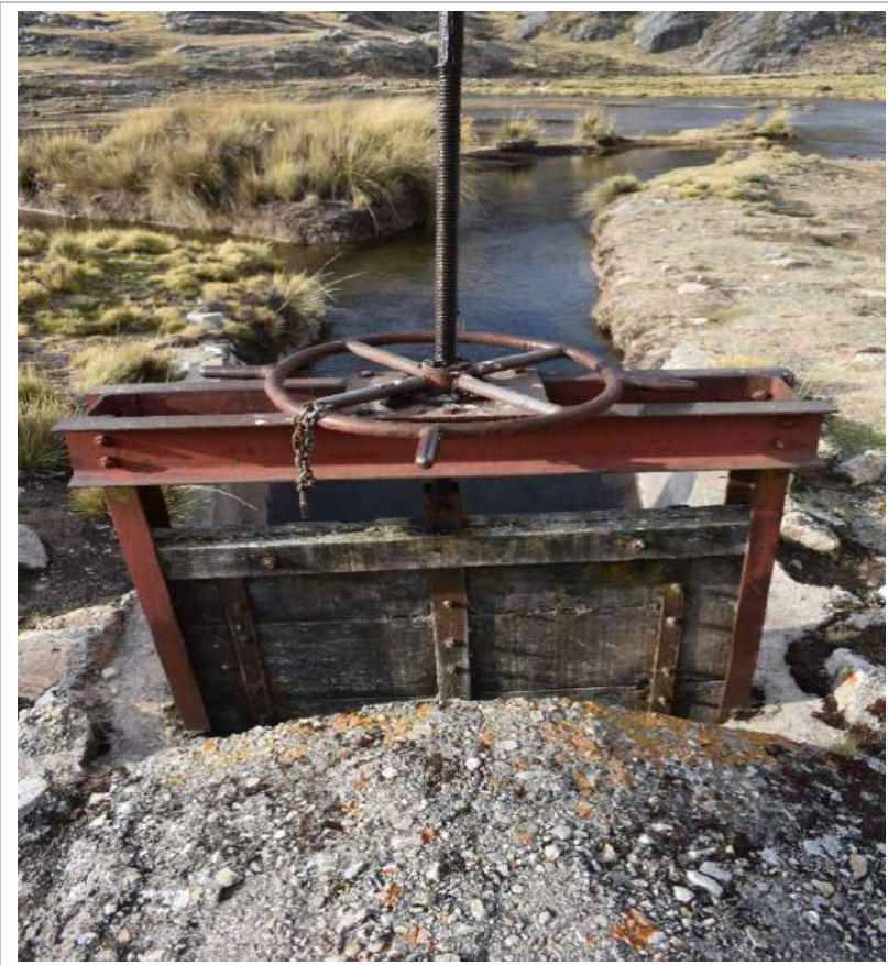
Figura 3.3 - 2 Bocatoma de la Laguna Yanahuin (vista panorámica)
