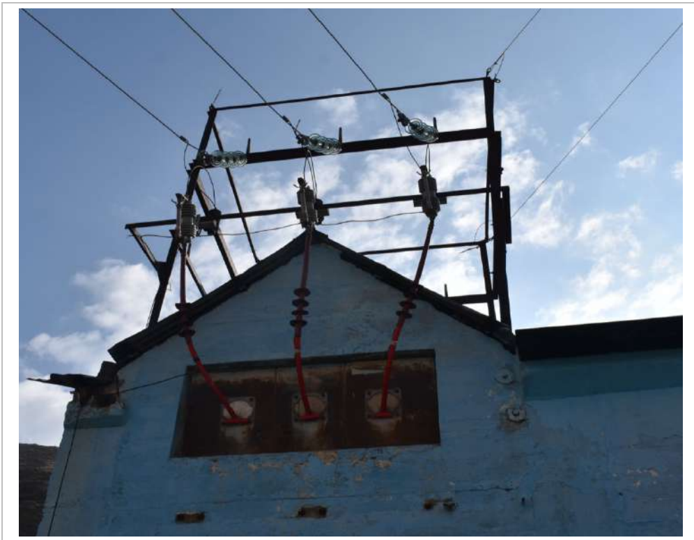
Figura 3.3 – 19 Pórtico de salida de la SE Yanahuin
