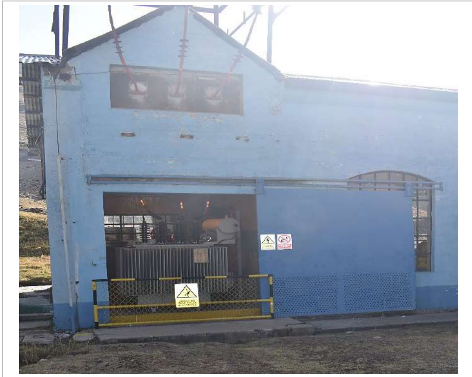
Figura 3.3 - 16 Subestación eléctrica (Vista panorámica)
