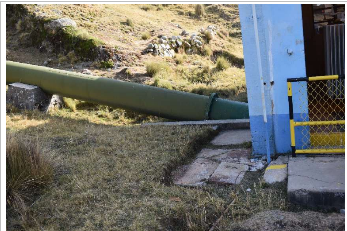
Figura 3.3 - 14 Ingreso de la Tubería forzada a la Casa de máquinas
