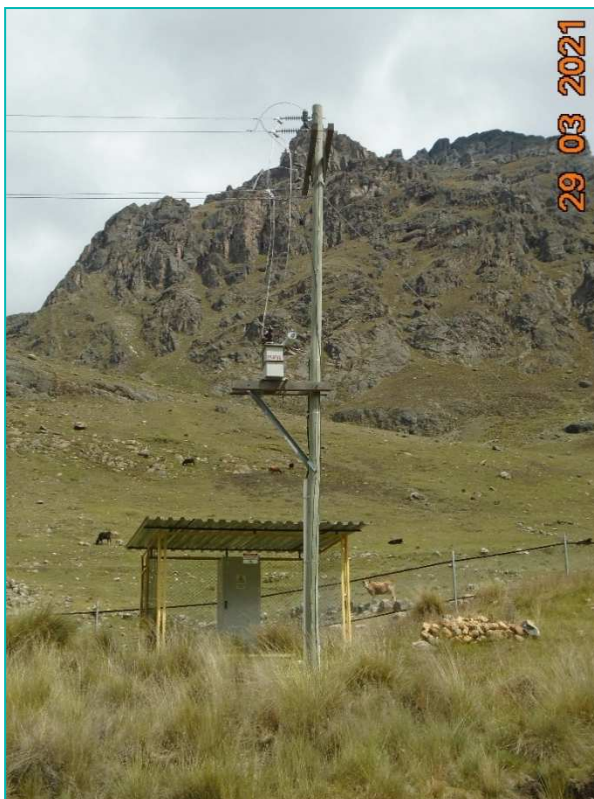
Fotografía 19: Transformador de Distribución - Canal de aforo: TD_C.AFORO_LT_HZA
