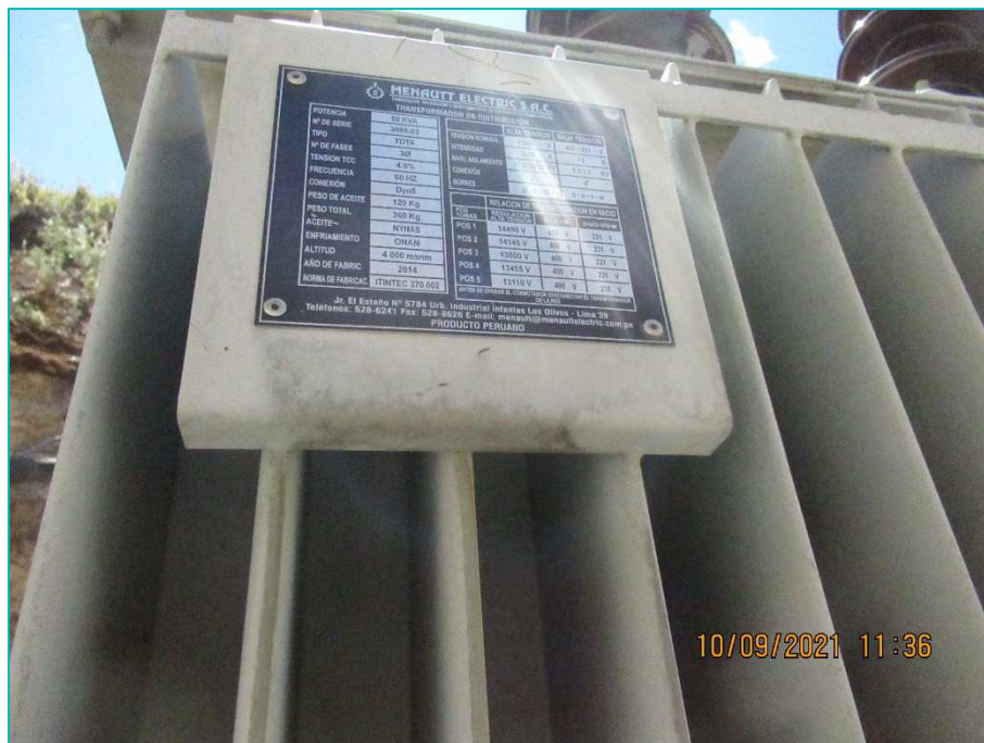
Fotografía 13: Transformador de Distribución - Ventana 3: TD_V3_LT_HZA
