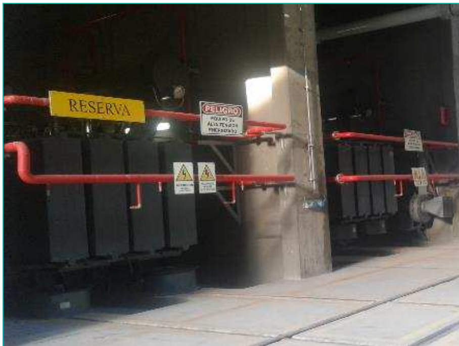
Fotografía 03: Transformadores de Potencia Reserva y Fase R (TP_RSV_CM_HZA y TP_Fase R_CM_HZA)
