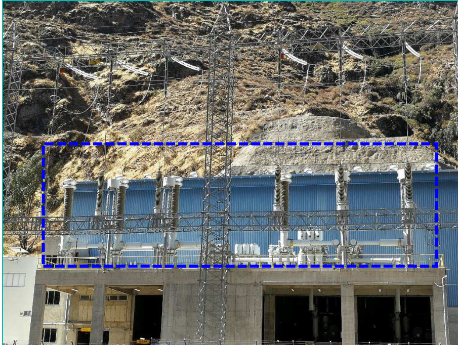
Fotografía 05: Pórtico – Transformadores de Tensión Capacitivo
