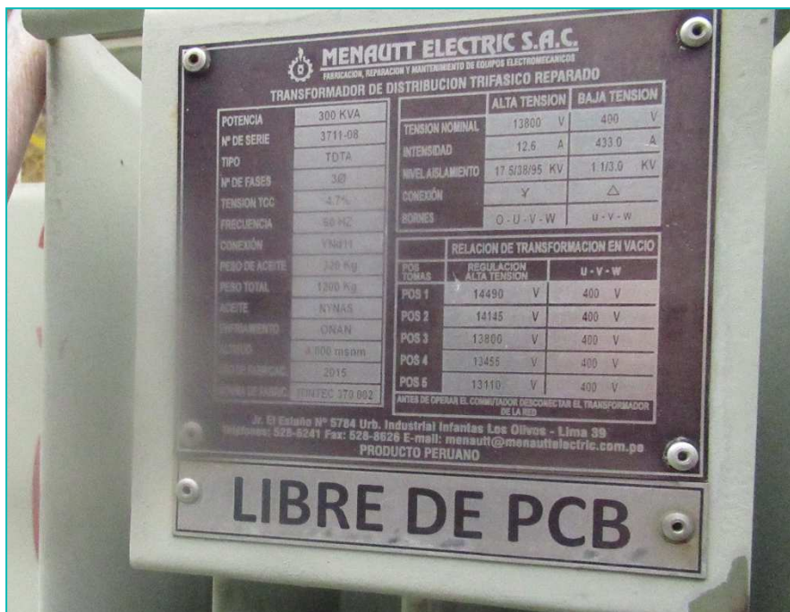
Fotografía 22: Placa: TD_ SALIDA PRESA:_CM_HZA
