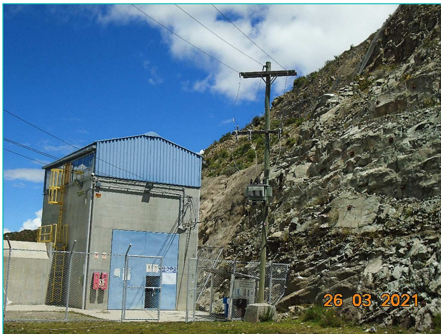
Fotografía 18: Transformador de Distribución - Casa de Válvulas: TD_C.VALVULAS_LT_HZA
