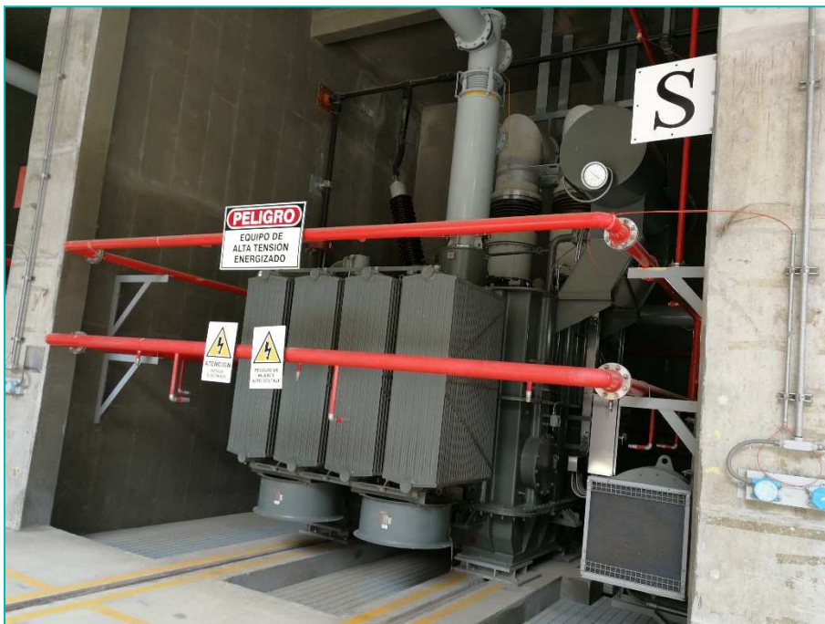
Fotografía 02: Transformador de Potencia Fase S (TP_Fase S_CM_HZA)
