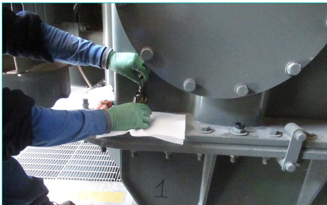
Fotografía 04: Toma de Muestra en Transformador de Potencia
