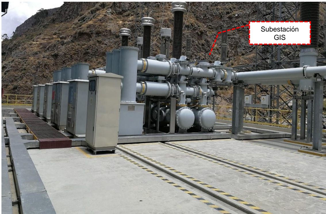
Fotografía N° 04: Vista Subestación GIS
