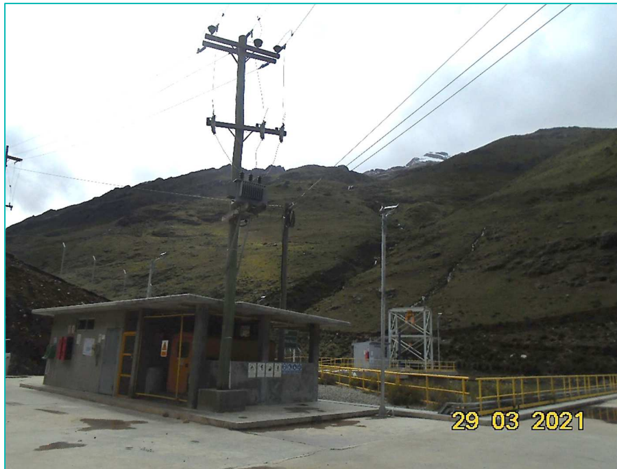
Fotografía 17: Transformador de Distribución - Presa Pallca: TD_P.PALLCA_LT_HZA
