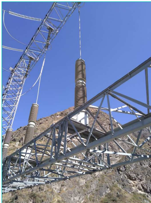
Fotografía 06: Transformadores de Tensión Capacitivo
