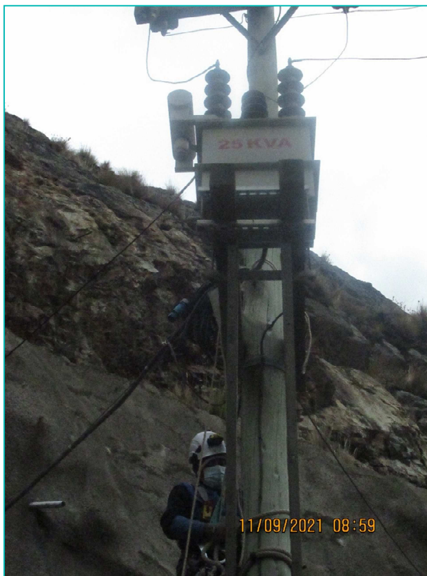
Fotografía 10: Toma de muestra en Transformador TD_V1_LT_HZA
