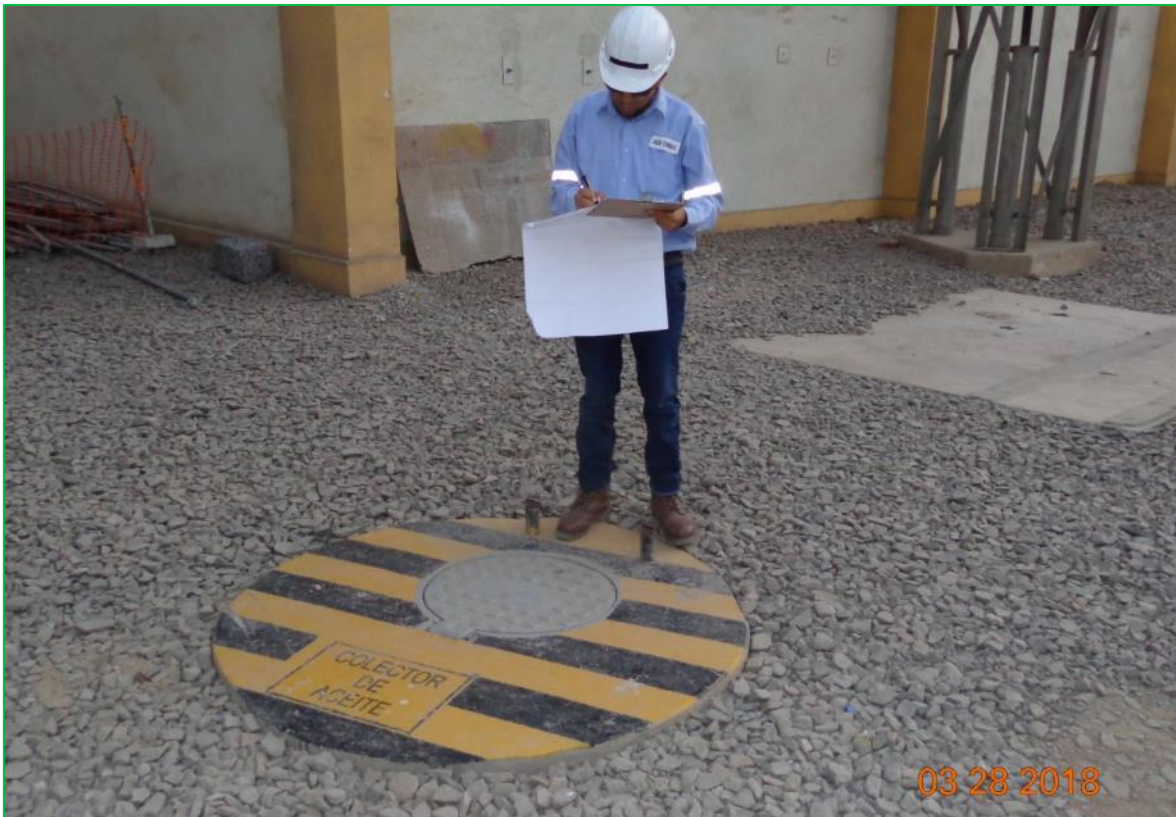
Figura 6.12. Colector de aceites en operación
