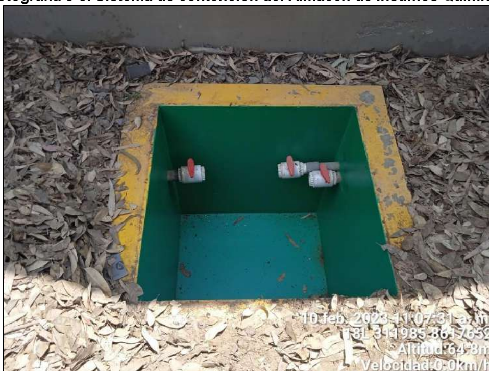
Fotografía 8-3. Sistema de contención del Almacén de Insumos Químicos
