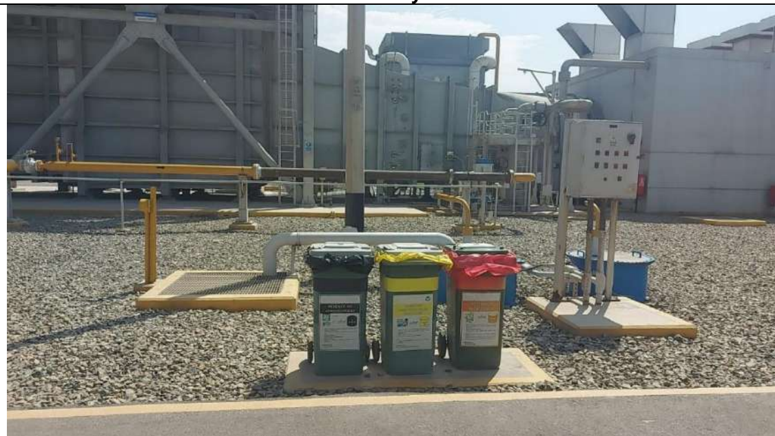
Frente a Turbina de Vapor
