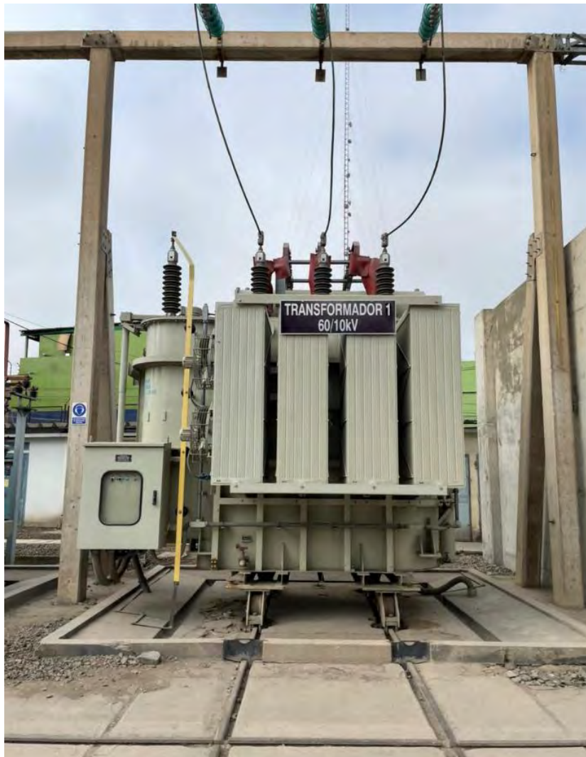
Figura 2.2. Ubicación del transformador de potencia 25MVA (TRF1).
