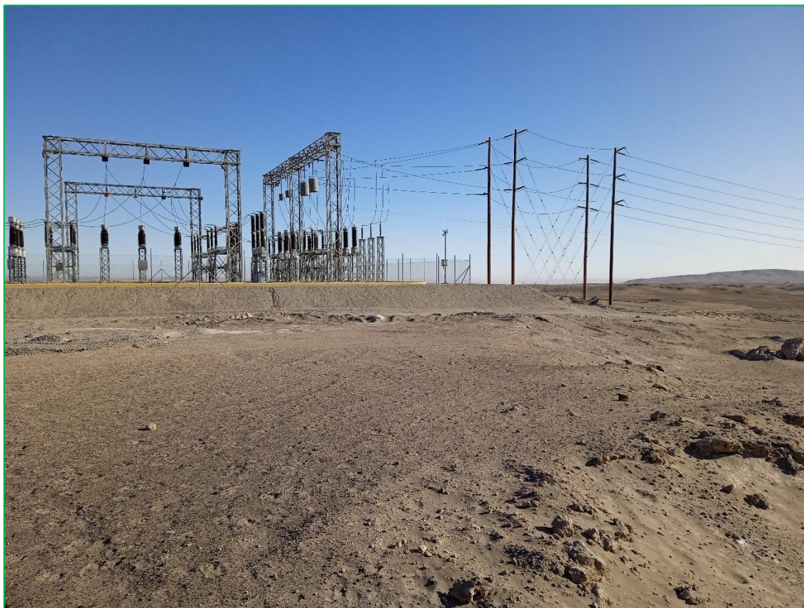
Figura 4.23 Subestación Eléctrica GTS Majes S.A.C.
