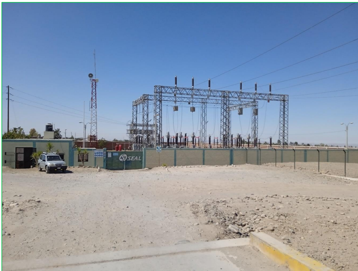
Figura 4.22 Subestación Eléctrica Majes
