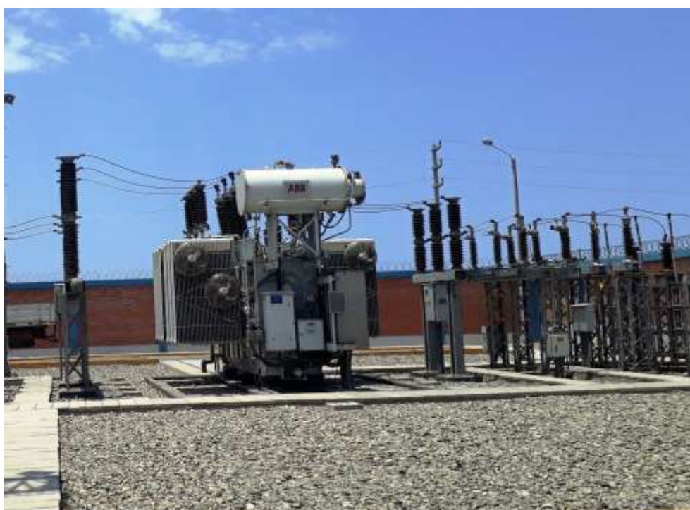
Figura 4. Transformador de la SE HUACA DEL SOL
