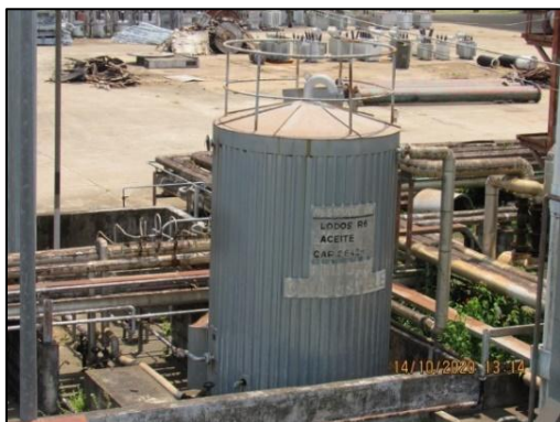
Figura 7.- Tanque de lodos
